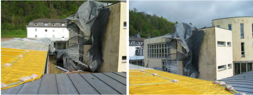
■ Abbildung 6 Dachschaden. © Reinhard Wilhelm
